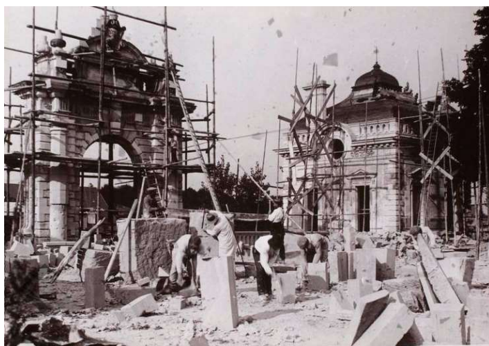
Blérancourt, Ouvriers travaillant à la restauration d'un pavillon et du portail, XX ème siècle , photographie © RMN-Grand Palais (Musée franco-américain du château de Blérancourt) / Harry Bréjat
